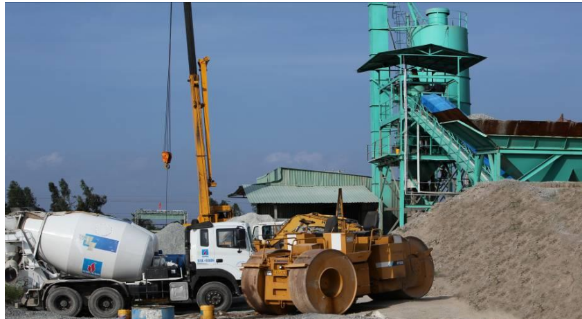
Trạm trộn bê tông tại Ấp Tắc Thủ, xã Hồ Thị Kỷ, huyện Thới Bình, tỉnh Cà Mau
