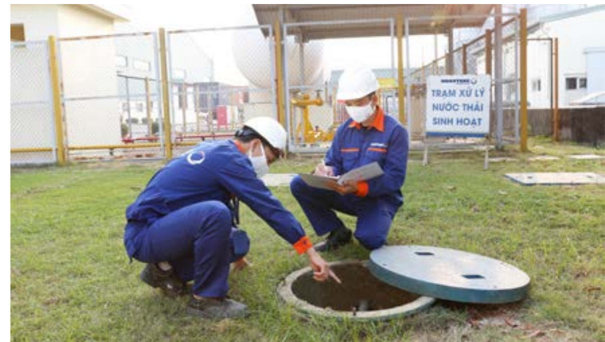
Nhân viên môi trường định kỳ kiểm tra hệ thống xử lý nước thải sinh hoạt của Công ty
