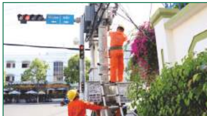
Kiểm tra vận hành các Trạm biến áp là công việc thường xuyên của ngành điện
