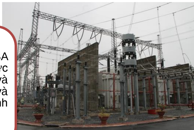
TBA 500kV Ô Môn
