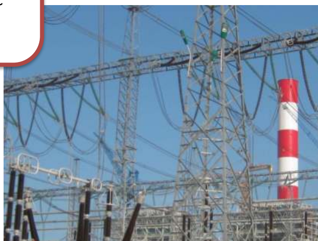
Trạm biến áp 500kV Vĩnh Tân
