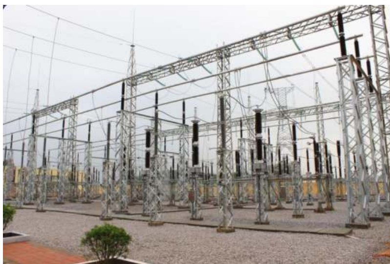
TBA 500kV Việt Trì
