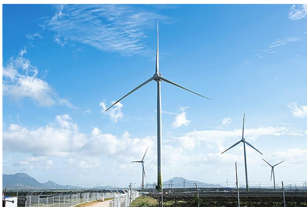
Điện gió Trung Nam
