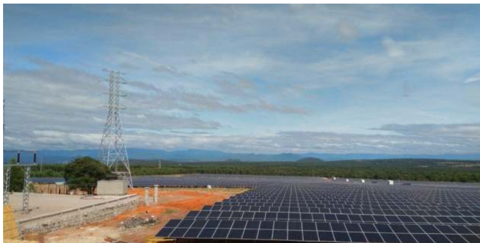
Nhà máy điện mặt trời Hồng Phong 5.2
