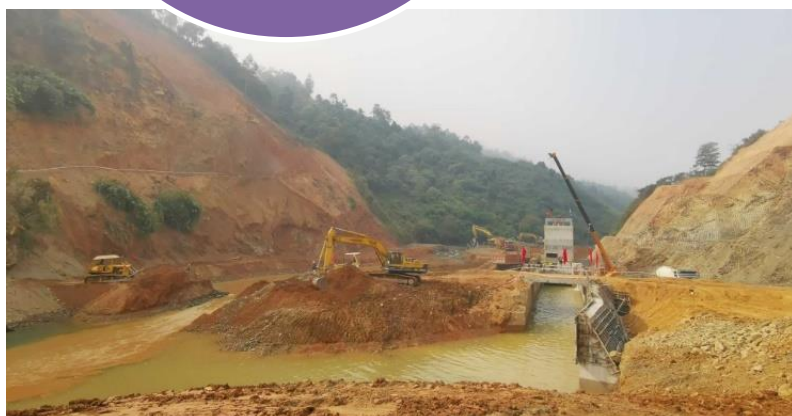
Thủy điện Sông Nhiệm 3
