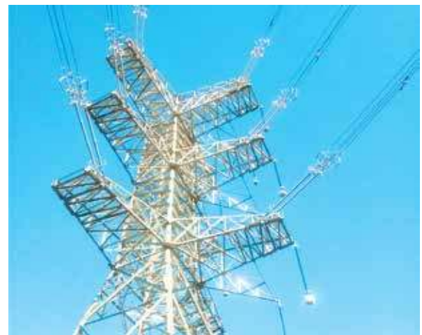
Cột đầu nối TBA 500kV Duyên Hải Gói EPC NMĐ Duyên Hải 2
