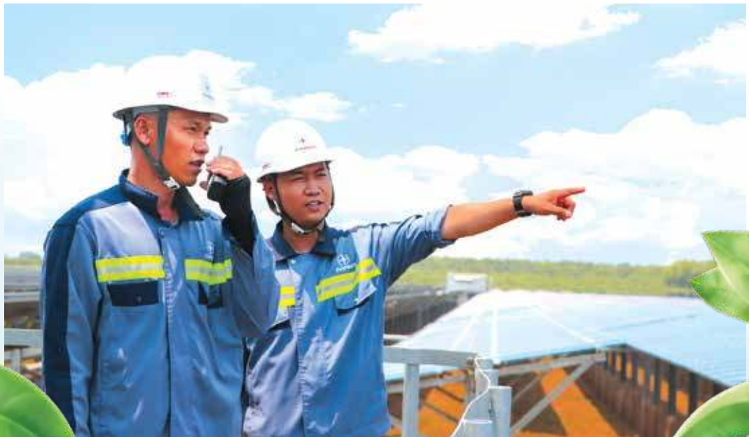
Điện mặt trời Dầu Tiếng 3MR (108MWp)
