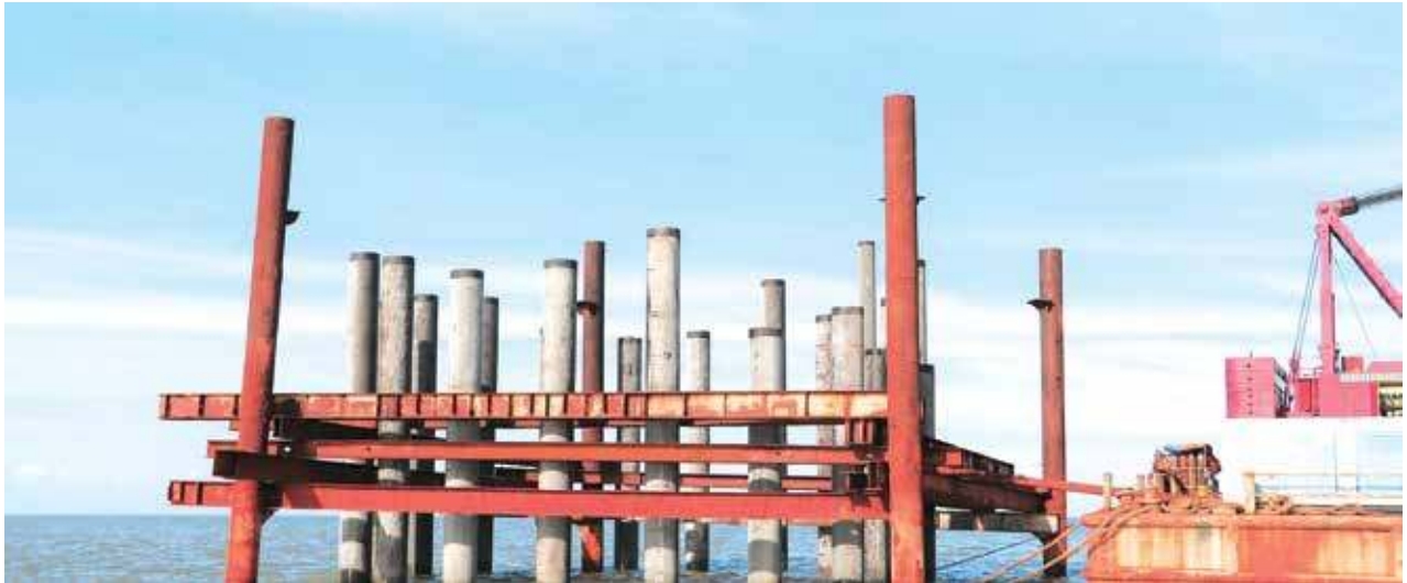
Điện gió Tân Thuận - EPC
