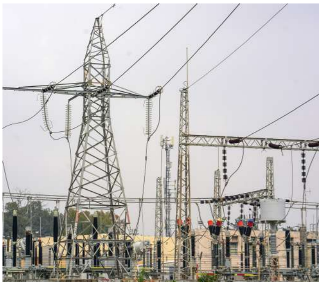
Trạm biến áp 110/22 kV Tuy Hạ
