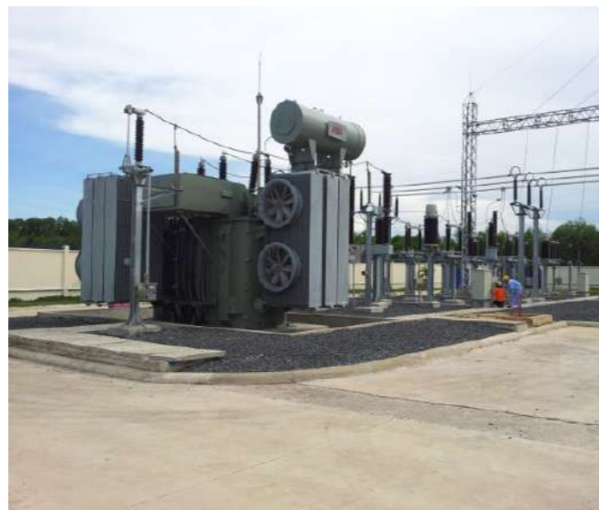
Trạm biến áp 110/22 kV Nhơn Trạch 5
