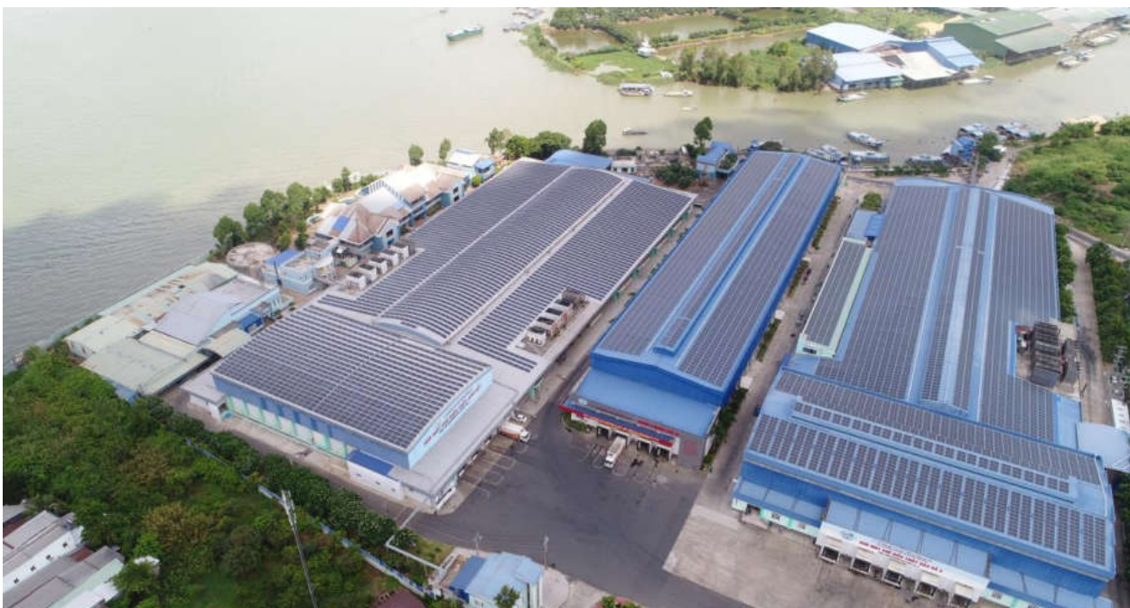
Hệ thống điện mặt trời trên nóc Nhà máy đông lạnh thủy sản IDI
