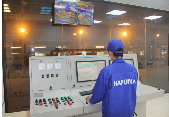
Ảnh: Công nhân Quản lý chất lượng tại Phòng điều khiển thử bơm
