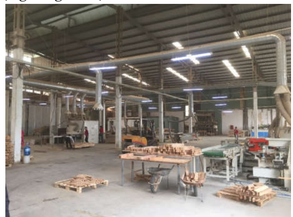
Hệ thống hút bụi hiện đại
